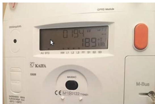
Foto: Slimme elektriciteits- en gasmeter
